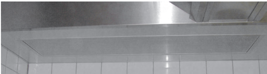
Abb. 18: Verdrängungsluftdurchlass in Decke integriert
