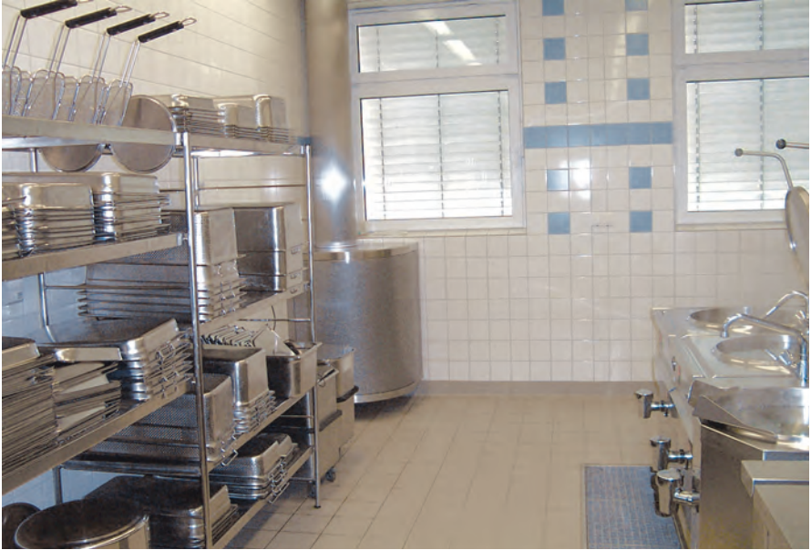
Abb. 15: Zylinderförmiger Quellluftdurchlass als Viertelzylinder in der Ecke über dem Fußboden positioniert (Reinigung des Raumes unter dem Auslass möglich)
