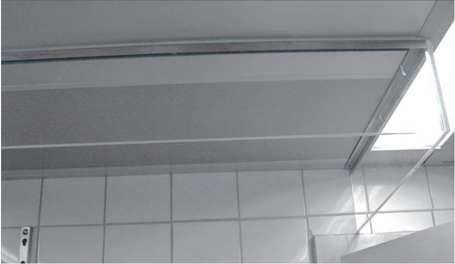
Abb. 19: Verdrängungsluftdurchlass mit Schürze zur Verringerung des Rücktransportes belasteter Luft aus dem Deckenbereich
