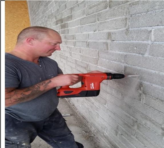
Slaba praksa – uporaba ročnega vrtalnika brez odsesavanja pri orodju (HSA, IE)
