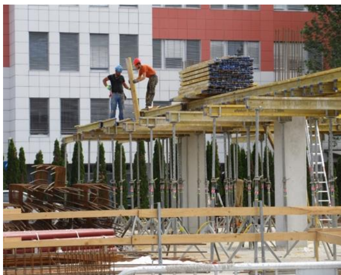
Slika 11: Nevarno izvajanje dela na višini
