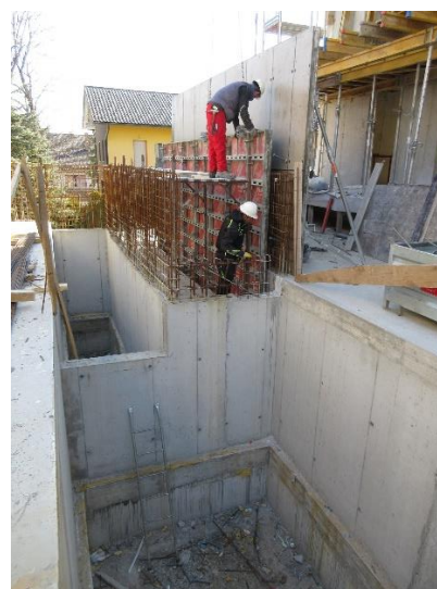
Slika 12: Nevarno izvajanje dela na višini
